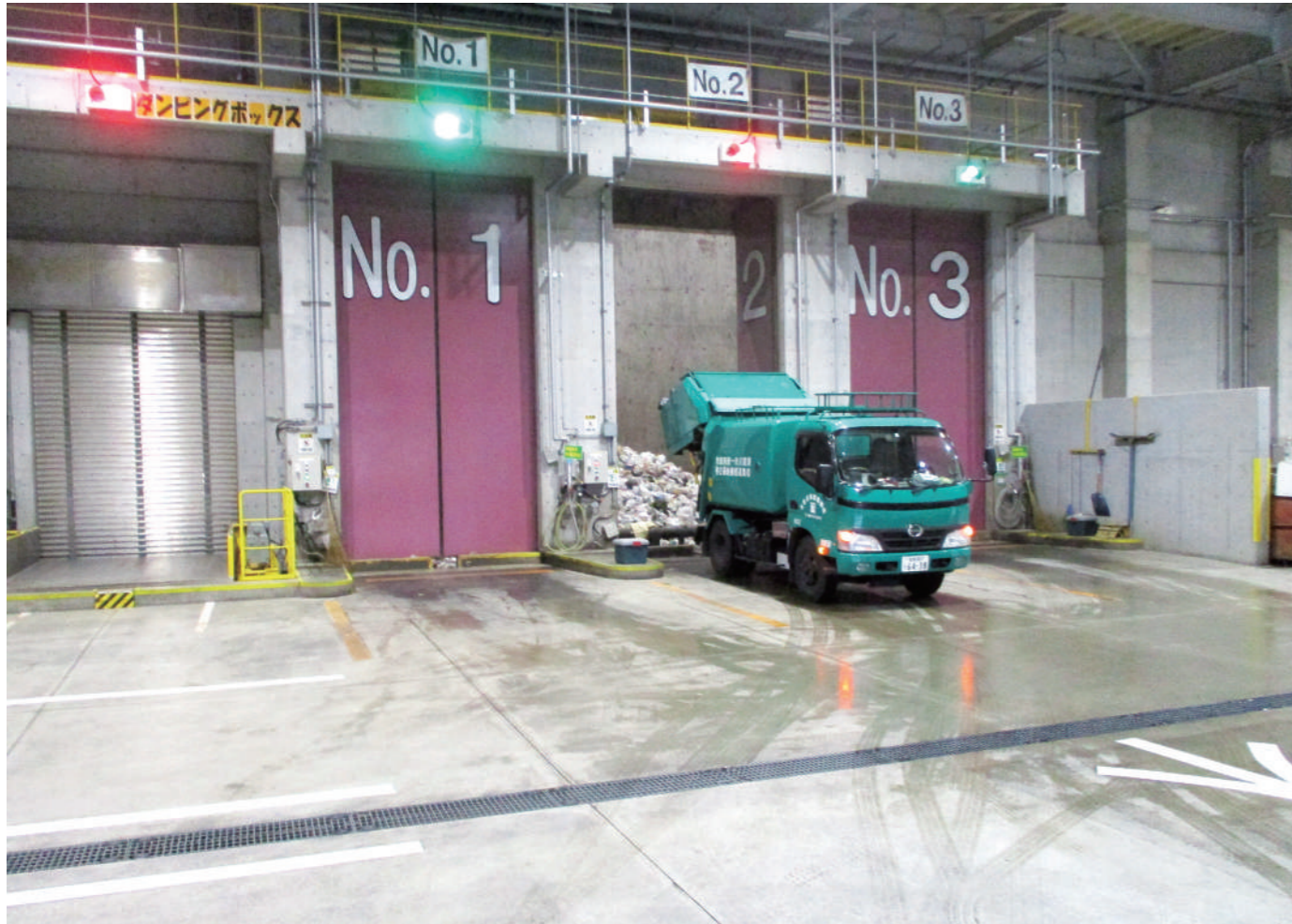
須賀川地方衛生センターごみ処理施設プラットフォーム内
